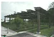
■ 調整池地上部の 共用太陽光発電システム
